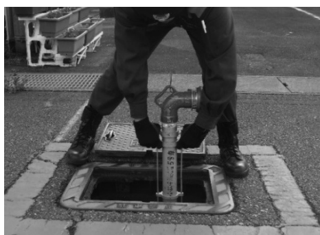
【写真 1 0】 消火栓にスタンドパイプを 結合
